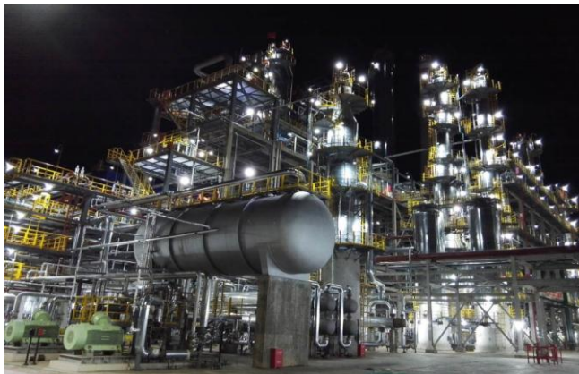
石油化工装置及其它危险场所
