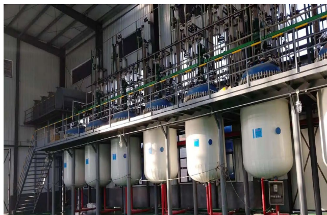
医药和化工企业车间及设备区域
