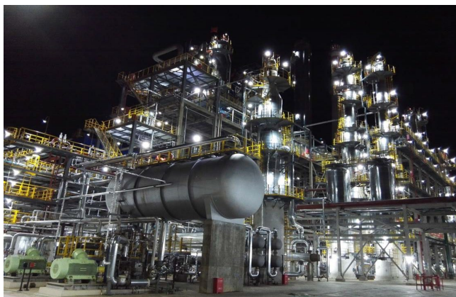
石油化工装置及其它危险场所
